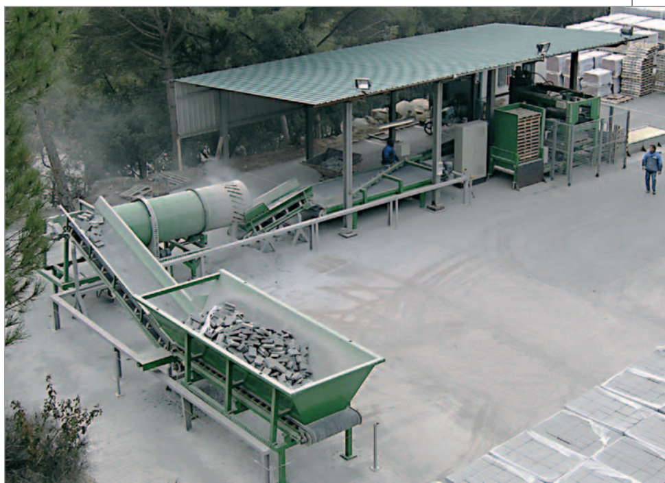
Gesamtansicht der Warning Alterungs- / Sortier- und Paketieranlage
